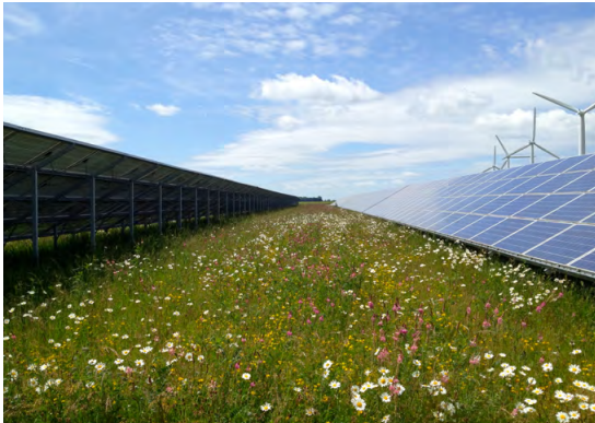
Bloemrijk grasland onder en tussen de rijen zonnepanelen
